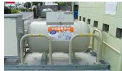
災害対策用LPガスバルク貯槽
