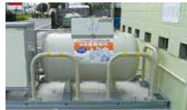
災害対策用LPガスバルク貯槽
